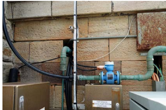
(d) Services behind substation (2018)
